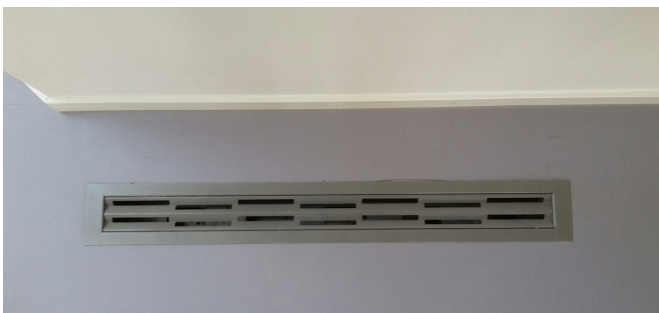
Zuluftgitter (automatische Lüftung)
