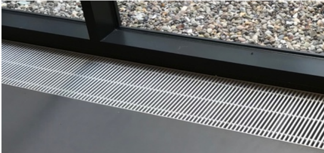
Unterflurkonvektor (Heizung im Boden)
