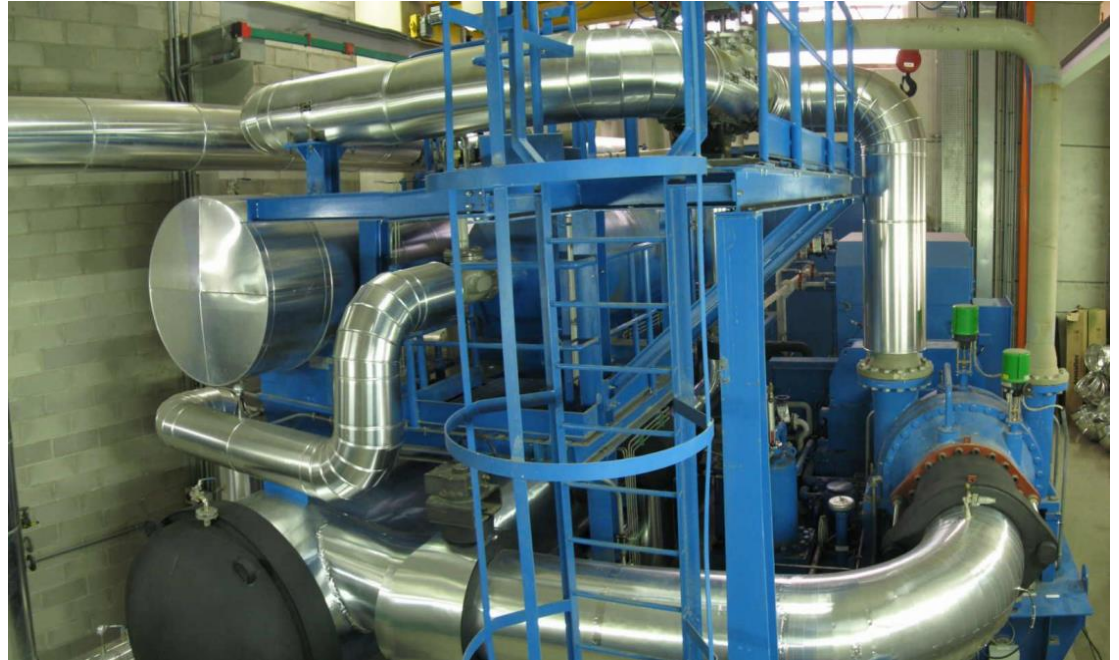
Trinkwasser-Großwärmepumpe Canavese Mailand Quelle: Masella
