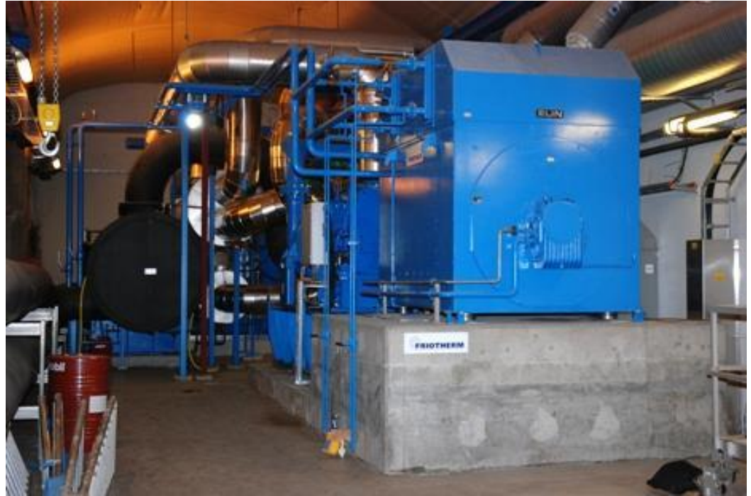
Abwasser-Wärmepumpe Friotherm Fernwärmeversorgung Oslo Quelle: www.vvsforum.no
